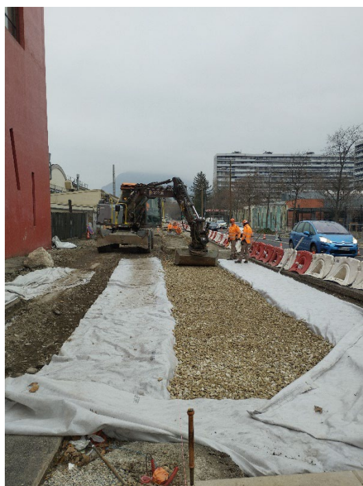
Figure 13 : Une visite technique interservices a été organisée (février 2025) lors de la pose du matériau drainant de la tranchée de Stockholm réalisée avenue Rhin et Danube à Grenoble
